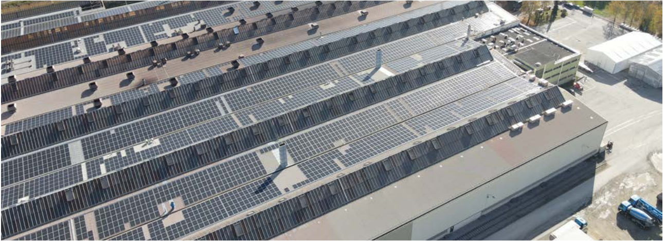
Abb.: PV-Anlage am Nahtlosrohrwalzwerk-Hallendach
