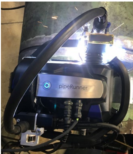
pipeRunner® en funcionamiento
