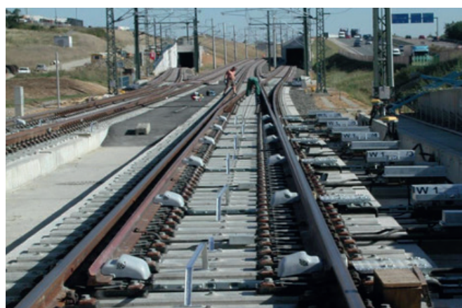
EW 60-10000/4000-1:39,173 fb mit 6 HRS-Verschlüssen in der Zungen vorrichtung (NBS Köln-Rhein/Main, Breckenheim)
