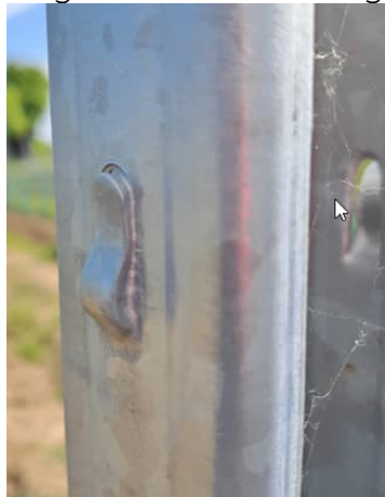
Abbildung: 1: Kralle durch Manipulationsschaden zugedrückt, somit keine Durchgängigkeit des Drahtes
